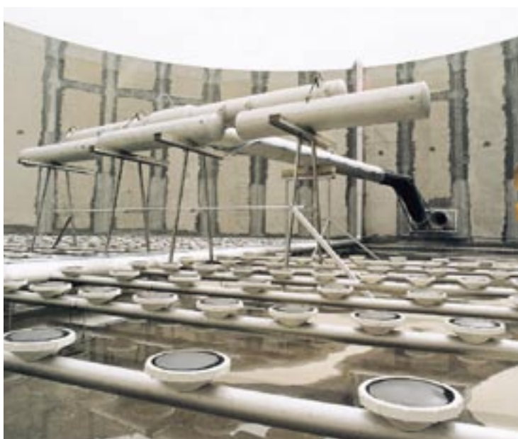
Décanteur Läckeby Products installé sur la station d'épuration de Kalmar, Suède
