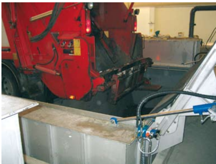
Versement de déchets ménagers dans un des bacs de réception installés.
