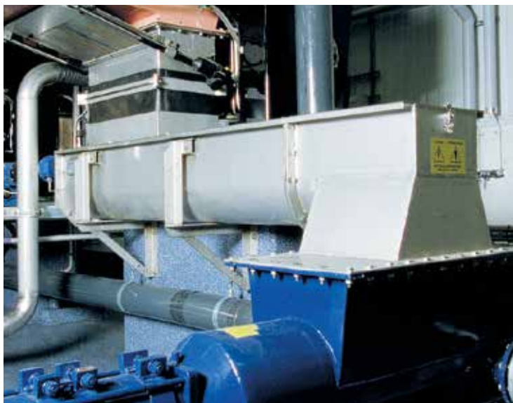
Installation av Läckeby Products skruvtransportör för transport av förtjockat slam från centrifug till slampump.
