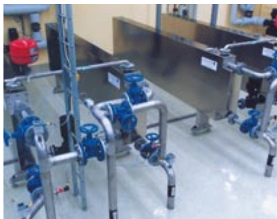
Deux unités d'échange thermique boues/boues installées dans la station d'épuration de Vimmerby.
