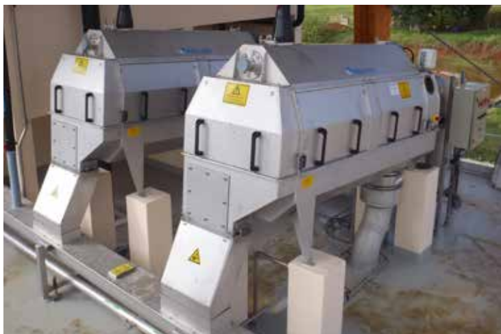
Installation av Roto-Sieve trumsilar modell RS-24 vid Guadeloupe reningsverk för skydd av membranläggningen.
